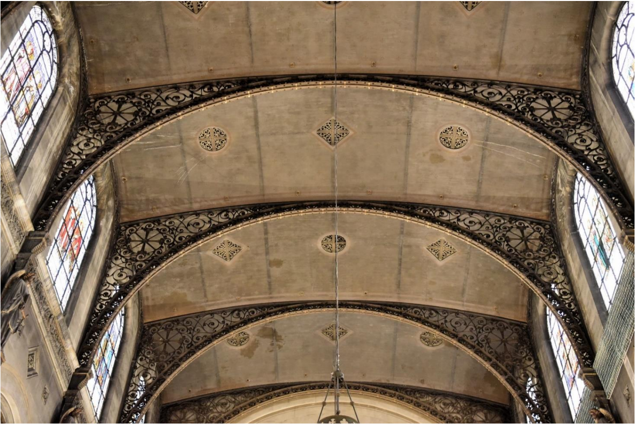
Abb. 73: Langhausgewölbe mit Eisenkonstruktionen der Gurtbögen in Form von Schwibbögen
